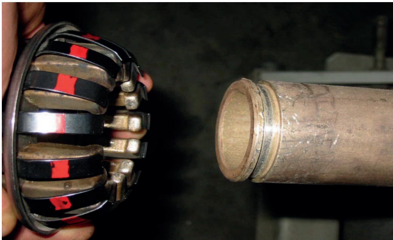
Amortiguador de interruptor marca AEG 245 tipo SF1F3 mecanismo CRR51
